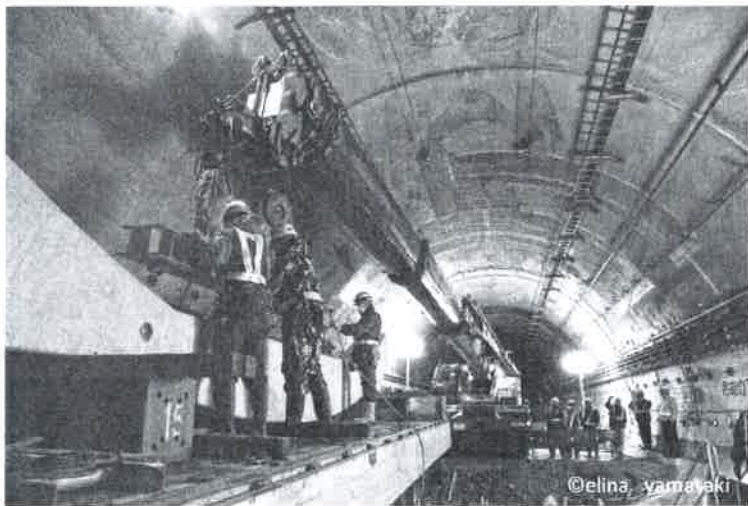
路面が隆起したトンネルの地盤強化工事（撮影／山崎エリナ氏）
